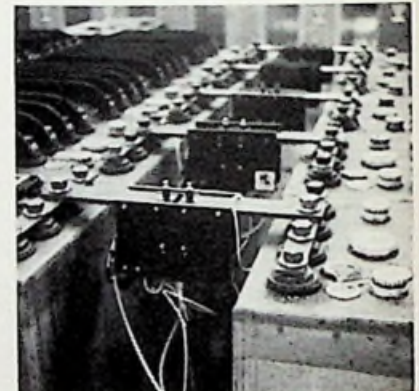
Afb. 5 De accu-opstelling is voorzien van veiligheidsschakelaars voor het geval dat een opgewekte bolbliksem niet „dooft”. „Door de vele veiligheidsmaatregelen”, aldus Dijkhuis, „duurt het nogal lang voordat de eerste bolbliksemplasma-proef kan starten.
